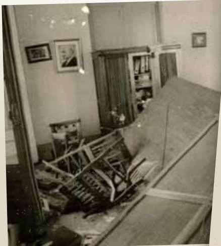
Roturas en las oficinas del BIC en calle Alvear. 1945
